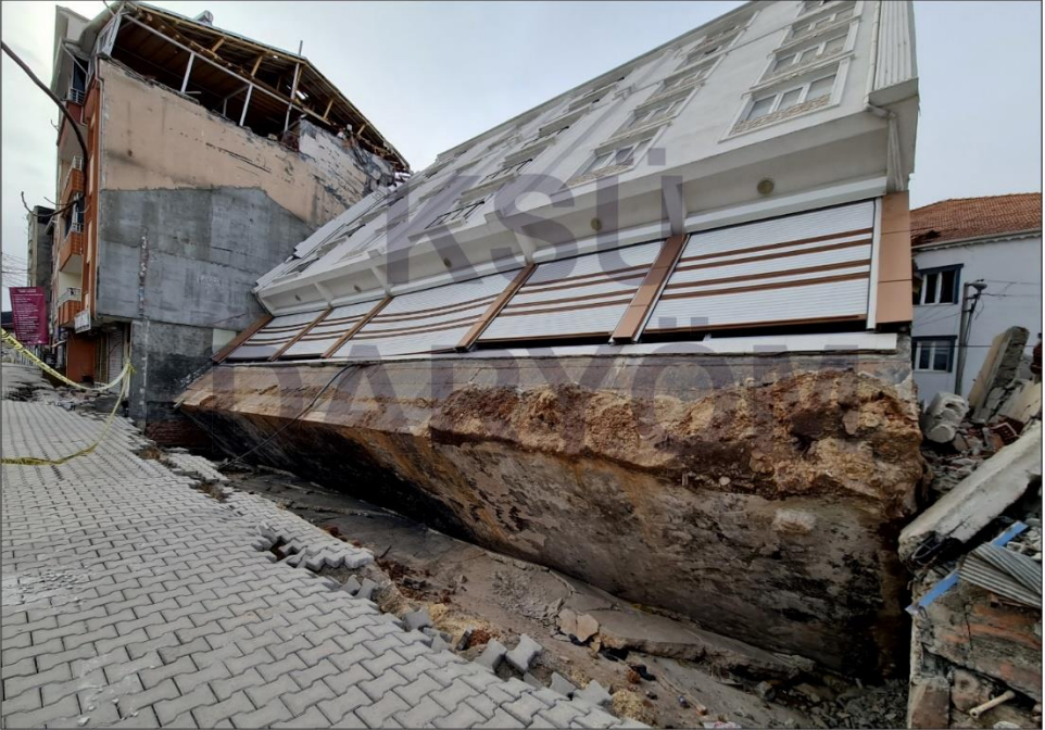
Şekil 16. 06 Şubat 2023 Pazarcık (Kahramanmaraş) depreminde Gölbaşı ilçesinin KB kesiminde alansal ölçekte gelişen sıvılaşma nedeniyle hasar görmeyen ancak arkasındaki evin üzerine devrilen binanın arazi görünümü
