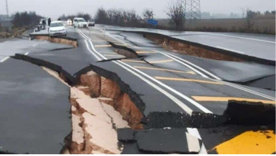
Şekil 9. Deprem sonrası TAG Otoyolunun Bahçe-Gaziantep Kesimi (Gören, 2023)
