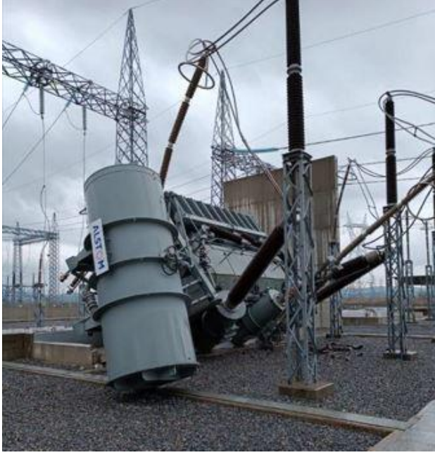
Şekil 14. Depremde Zarar Gören Elektrik Hatları (Dülger, 2023)
