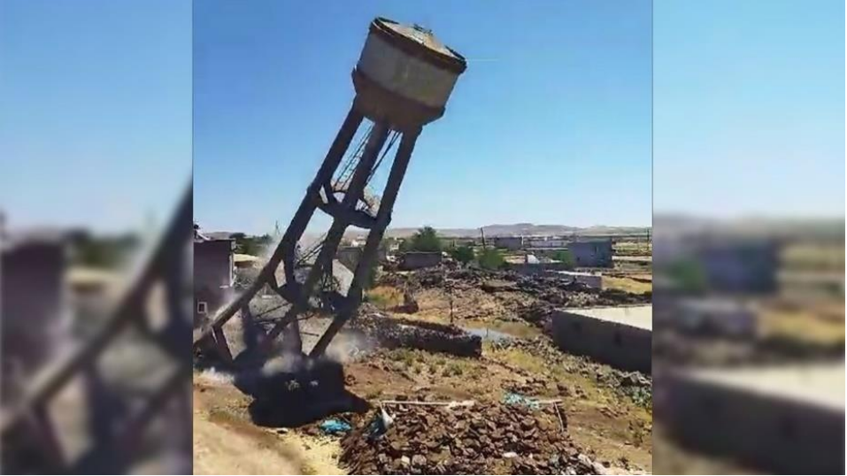
Şekil 6. Depremde Zarar Gören Su Kulesi (Anonim, 2023c)
