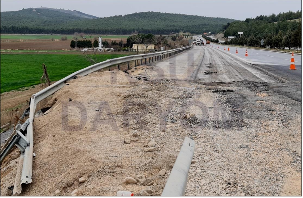
Şekil 12. 06 Şubat 2023 Pazarcık (Kahramanmaraş) depreminde, Kapiçam Mahallesi güneyinde Kahramanmaraş-Gaziantep karayolunu kesen ve 4,5 m sol yanal atım oluşturan Pazarcık Segmenti'ne ait yüzey kırığının arazi görünümü
