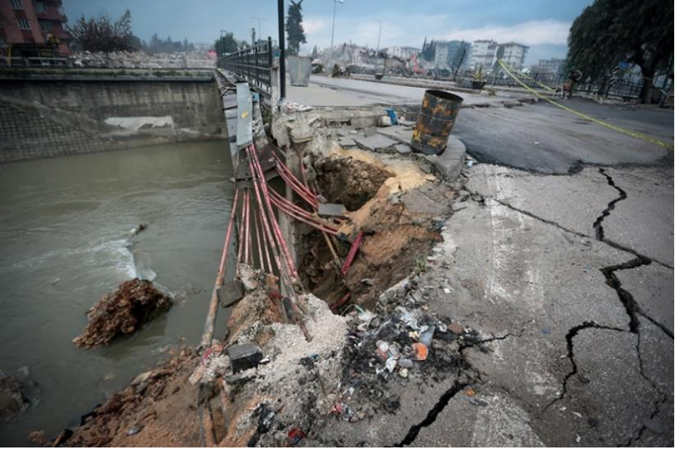
Şekil 10. Hatay'da Köprülerde Meydana Gelen Zarar (Yılmaz ve Balcıkoca, 2023)
