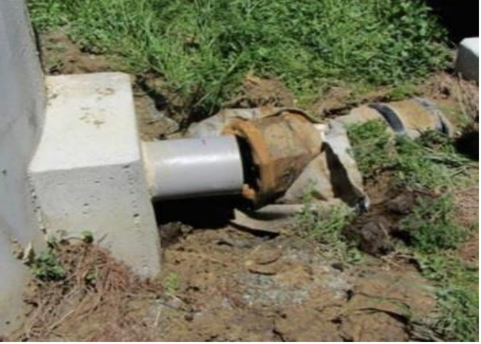
Şekil 4. Deprem Nedeniyle Zarar Gören Sulama Sistemleri (Hughes, 2017)
