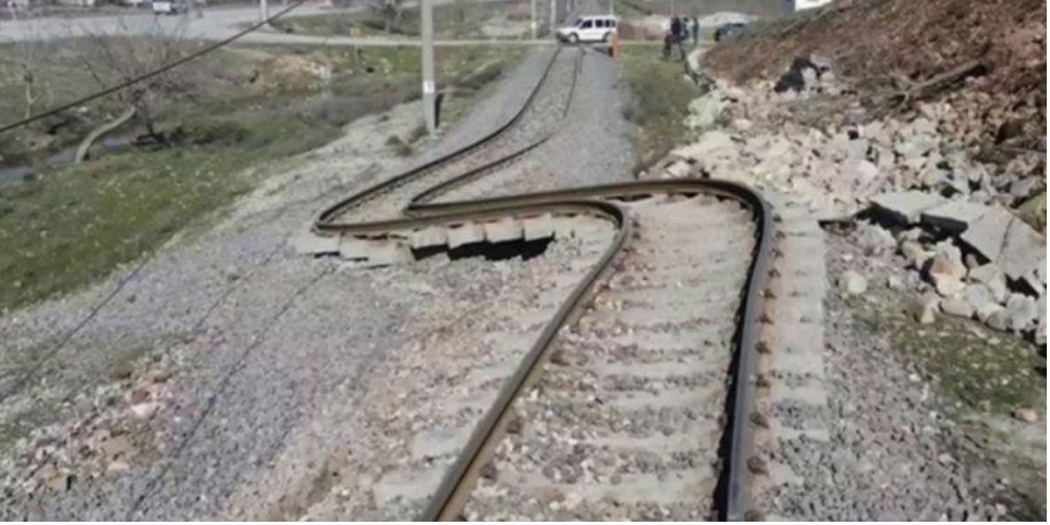
Şekil 18. Türkoğlu (Kahramanmaraş)-Nurdağı (Gaziantep) arasındaki demiryolu hattının 06 Şubat 2023 Pazarcık (Kahramanmaraş) depremi sırasında oluşan Amanos Segmenti'ne ait kırık tarafından kesildiği alanda gözlenen sol yanal ötelenmeye ait arazi görüntüsü
