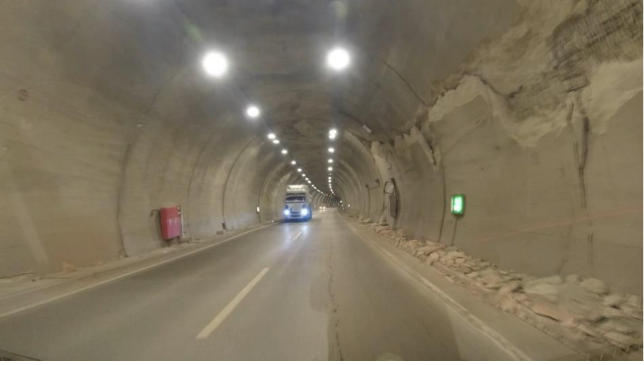
Şekil 11. Erkenek Tüneli'nin Deprem Sonrası Gördüğü Zarar (Anonim, 2023e)
