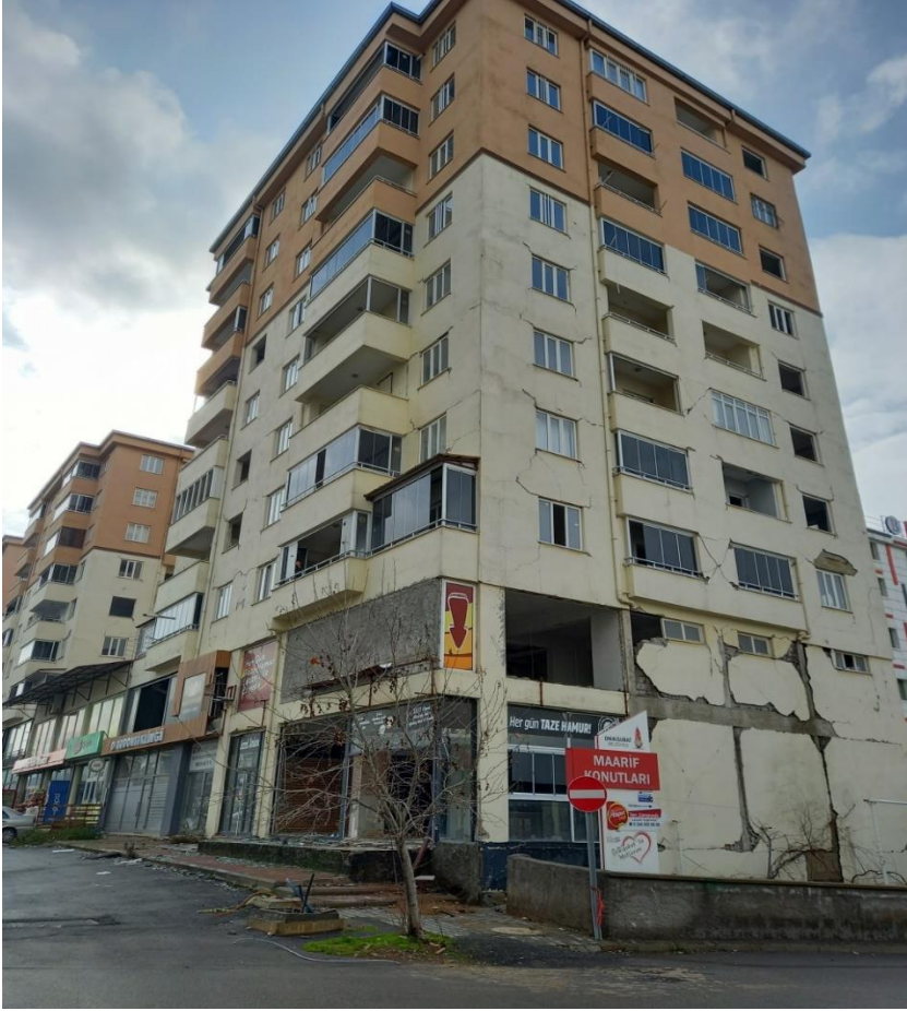
Fotoğraf 1. Gevşek Zemine İnşa Edilen ve Depremde Hasar Alan Bir Bina
