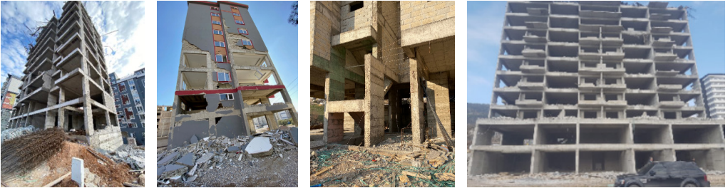
Resim 4. Kahramanmaraş’ta zemin katta dükkan ve asma kat düzenlemesi ile düşeyde ve planda düzensizlikler nedeniyle deprem sonrasında yapısal ve yapısal olmayan hasar oluşumları
